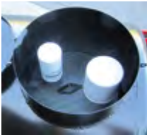
Red escurrifiltros interna. Rede de drenagem de filtros interna.
